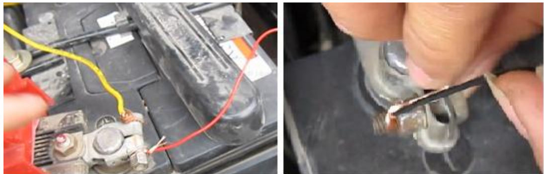
Hình 2.3: Đấu nối dây nguồn của thiết bị trực tiếp với ắc quy
